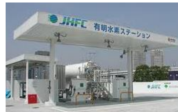
水素ステーション
